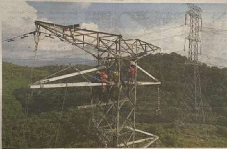
KEUTAMAAN TNB terhadap Pelan Pemulihan Negara termasuk memastikan bekalan elektrik yang berdaya harap kepada hospital, PSV, PPV serta lebih 9 juta pelanggan di seluruh negara.
