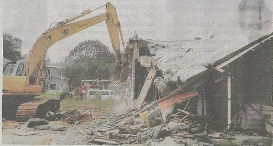
Struktur rumah yang dirobohkan di Sungai Chinchin, Gombak semalam.
