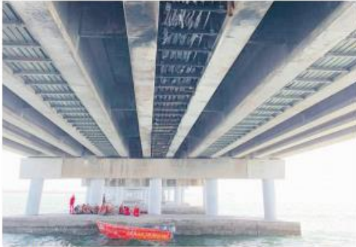
Kabel di bawah Jambatan Pulau Pinang yang terbakar dalam kejadian pada Isnin dua minggu lalu.
