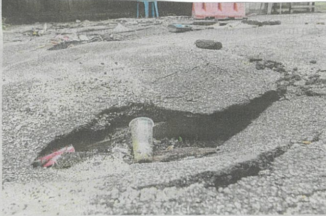
KEADAAN jalan yang mendap di Flat PKNS Jalan Tun Razak, Kampung Baru.
