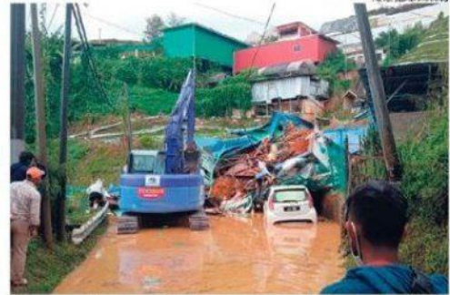
Operasi mencari mayat mangsa tunut menggunakan jengkaut bagi membersihkan sisa runtuhannya dan lumpur.
