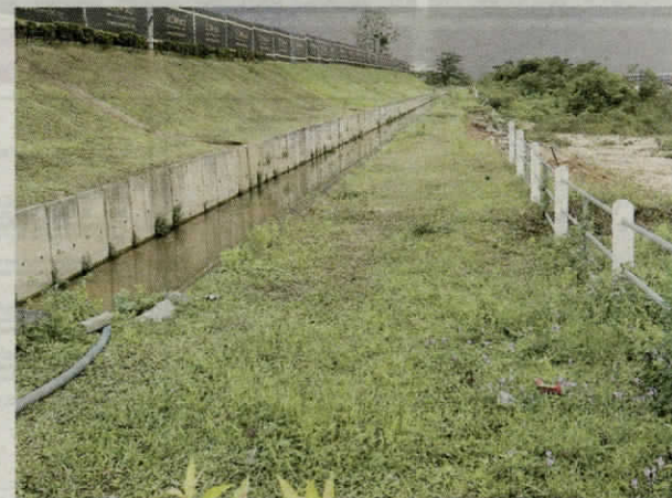
Sistem 'U-drain' dan kolam takungan pemaju tidak dapat menampung air ketika hujan lebat menyebabkan banjir kilat dan banjir lumpur.
