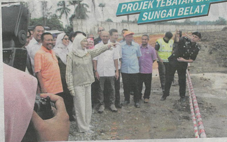
Wan Azizah (dua dari kiri) meninjau projek menaiktaraf dan pembinaan tebatan banjir Sungai Belat semalam.
