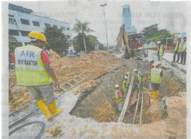
BEBERAPA pekerja kontraktor mengeluarkan paip saluran air yang pecah di Jalan Universiti, semalam.
