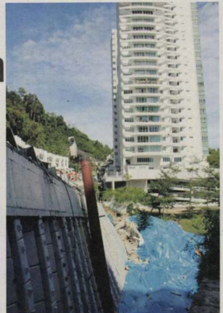
Perumahan mewah cerun bukit yang belum diduduki tetapi struktur jalannya telah runtuh.
